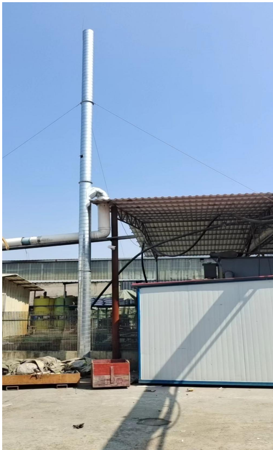
污水处理站废气排气筒
