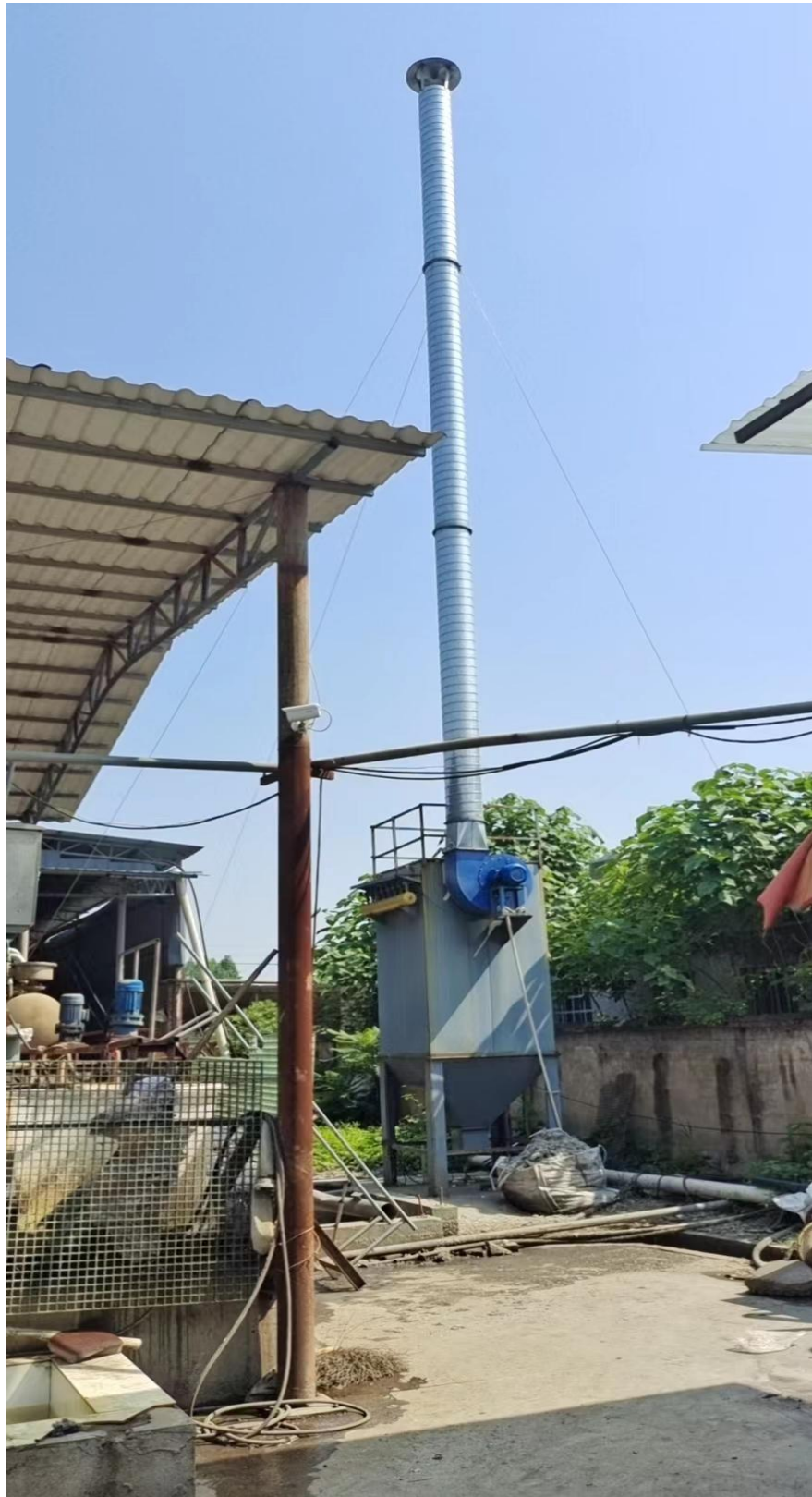
破碎粉尘排气筒照片
