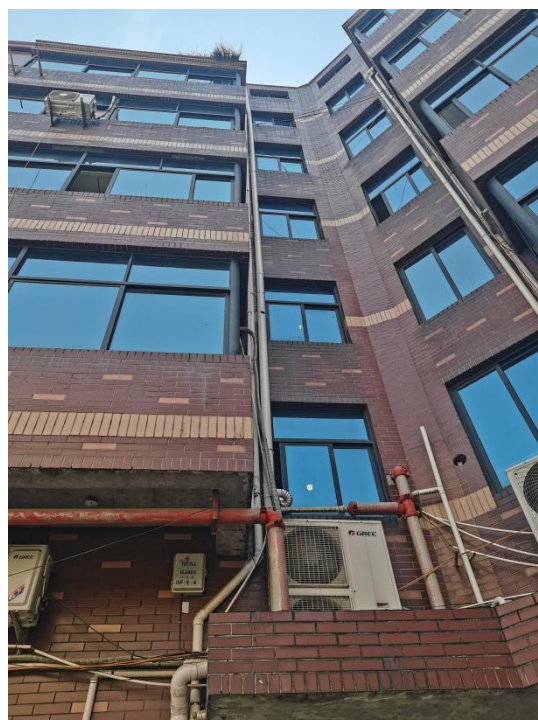
污水处理臭气收集管道
