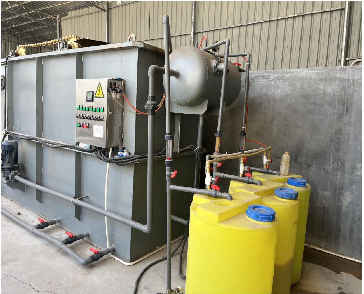
附件 6 废水处理设施照片
