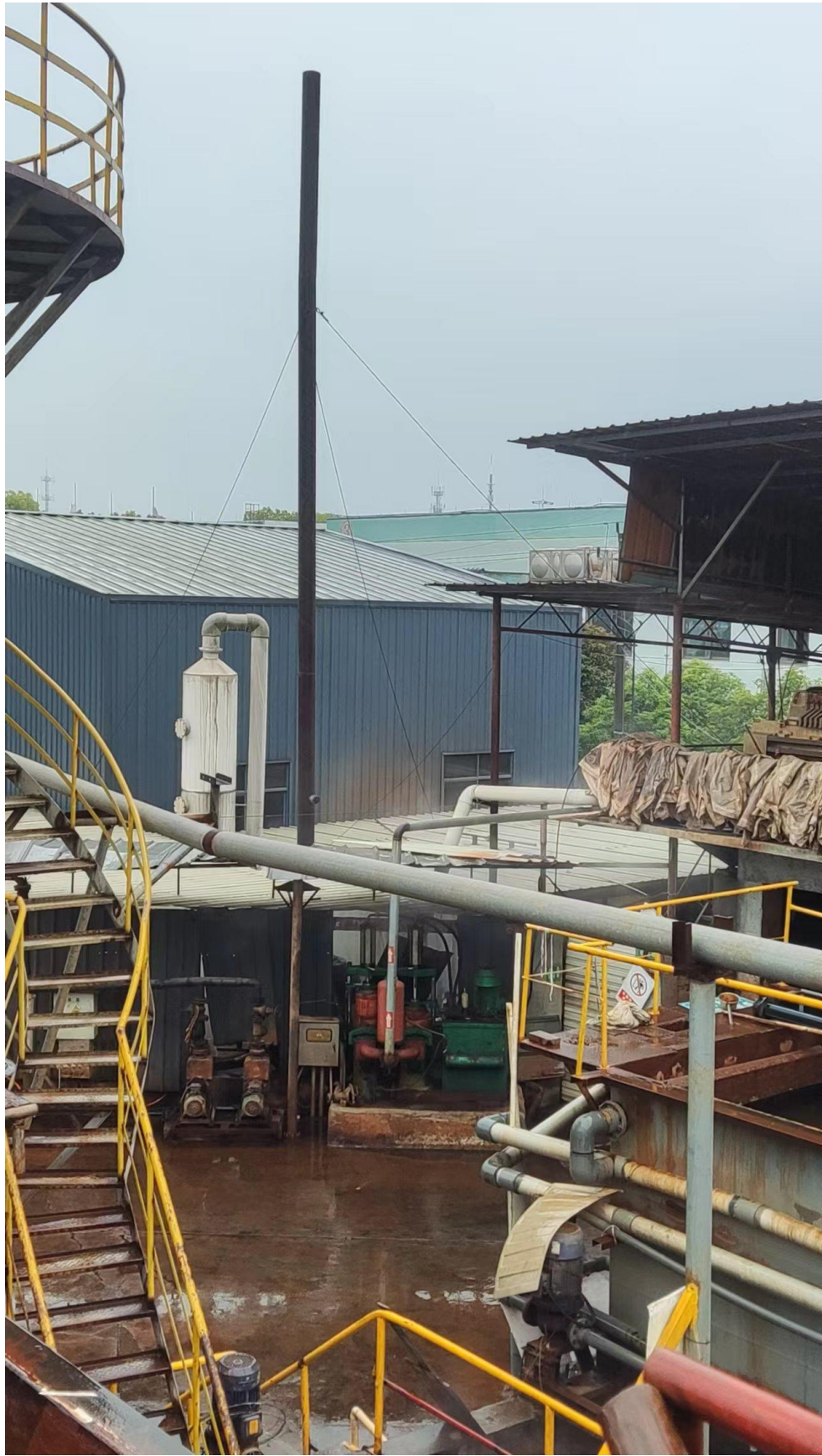
污水站排气筒照片
