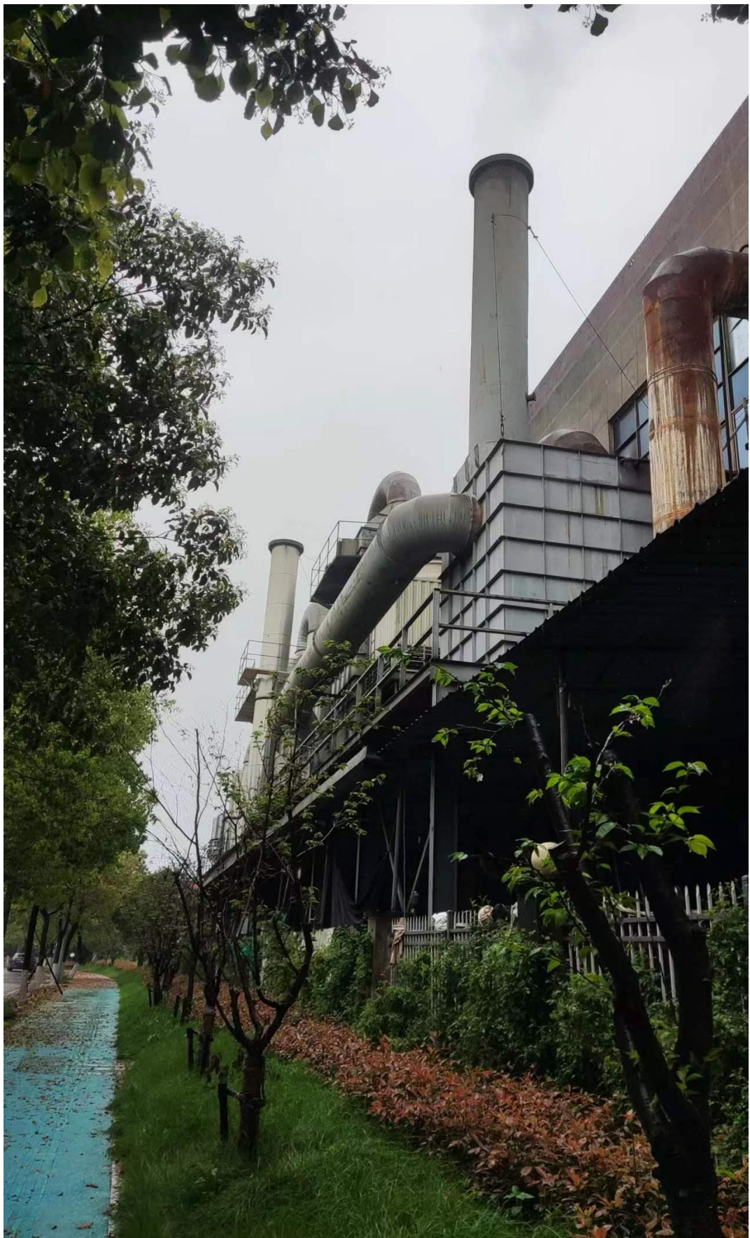
染整废气排气筒照片
