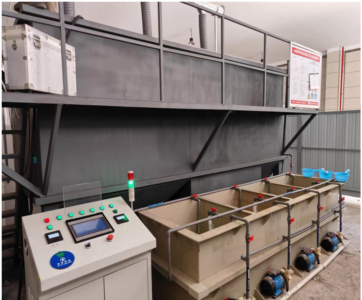
附件 6 污水处理设施照片
