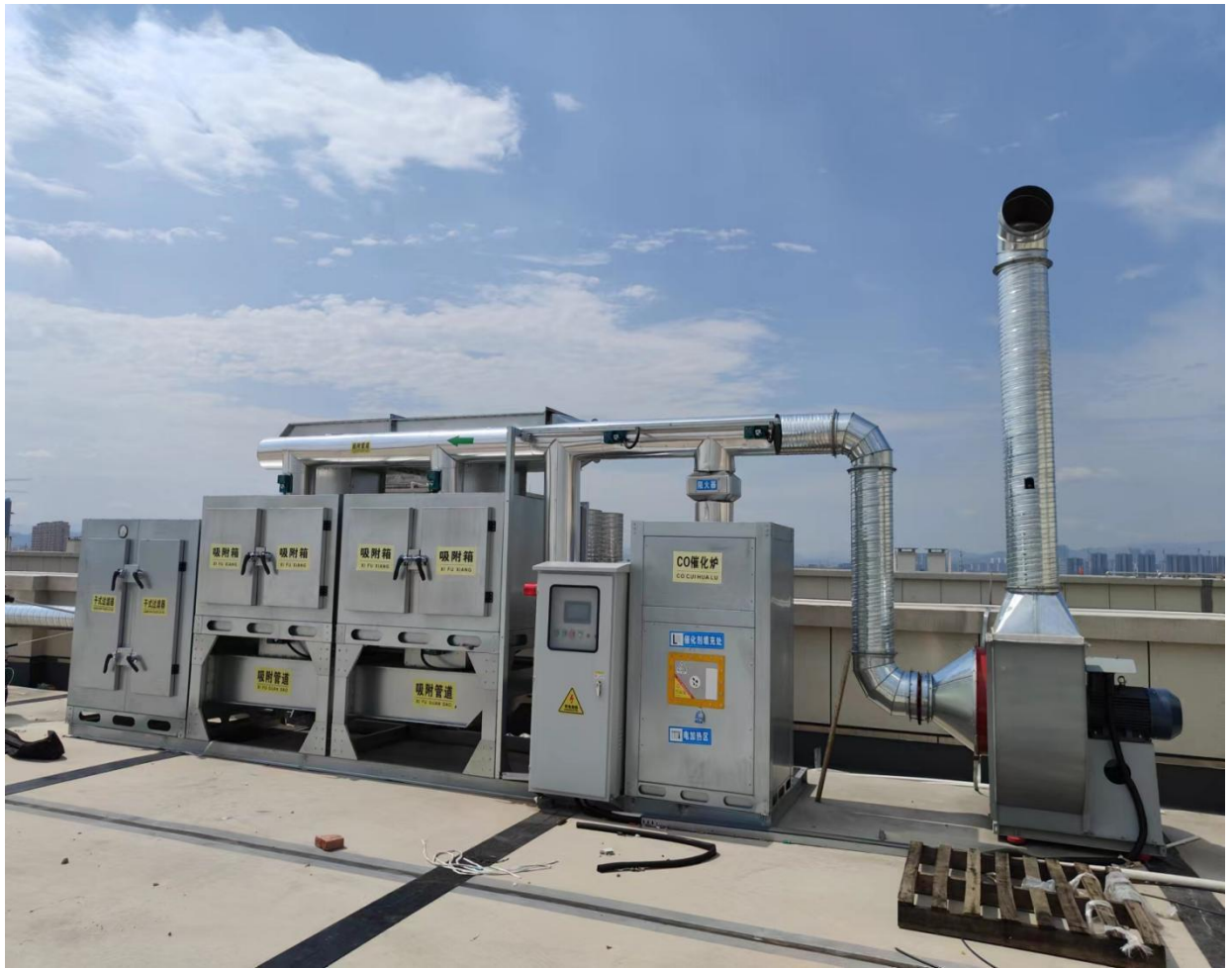
附件8 喷漆及注液废气处理设施照片
