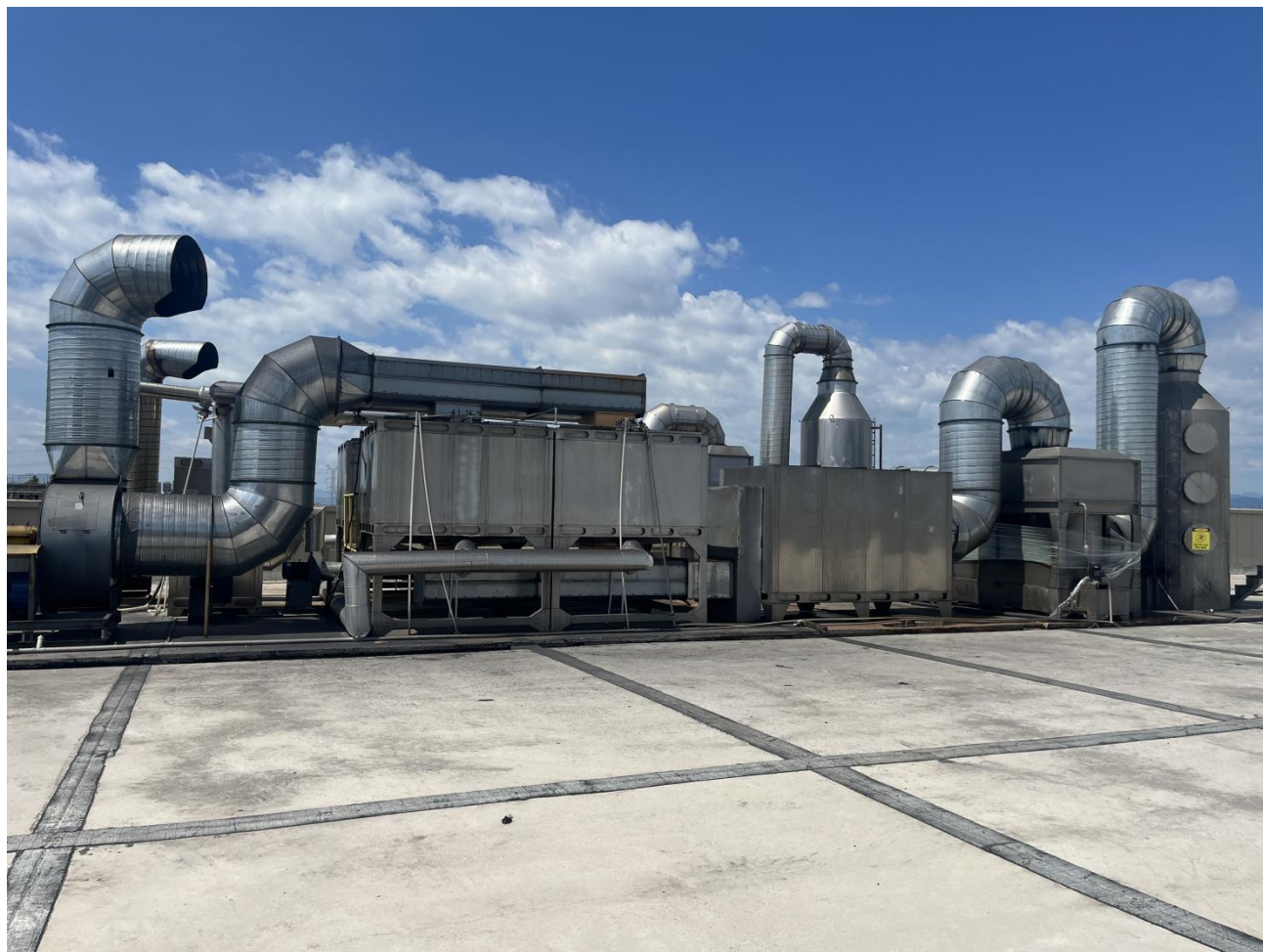
附件6 废气处理设施照片
