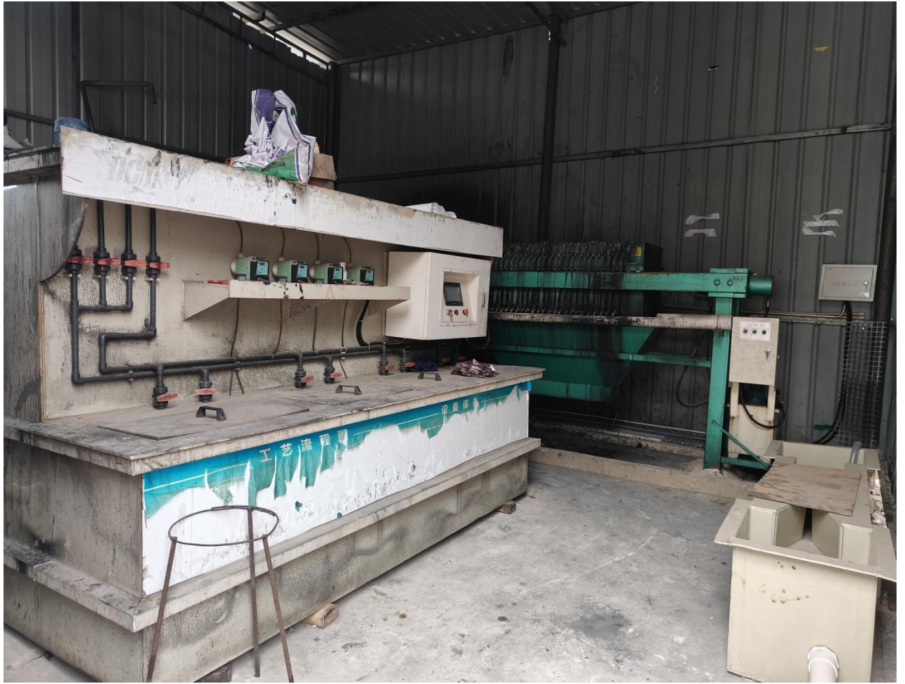
附件 6 污水处理设施照片
