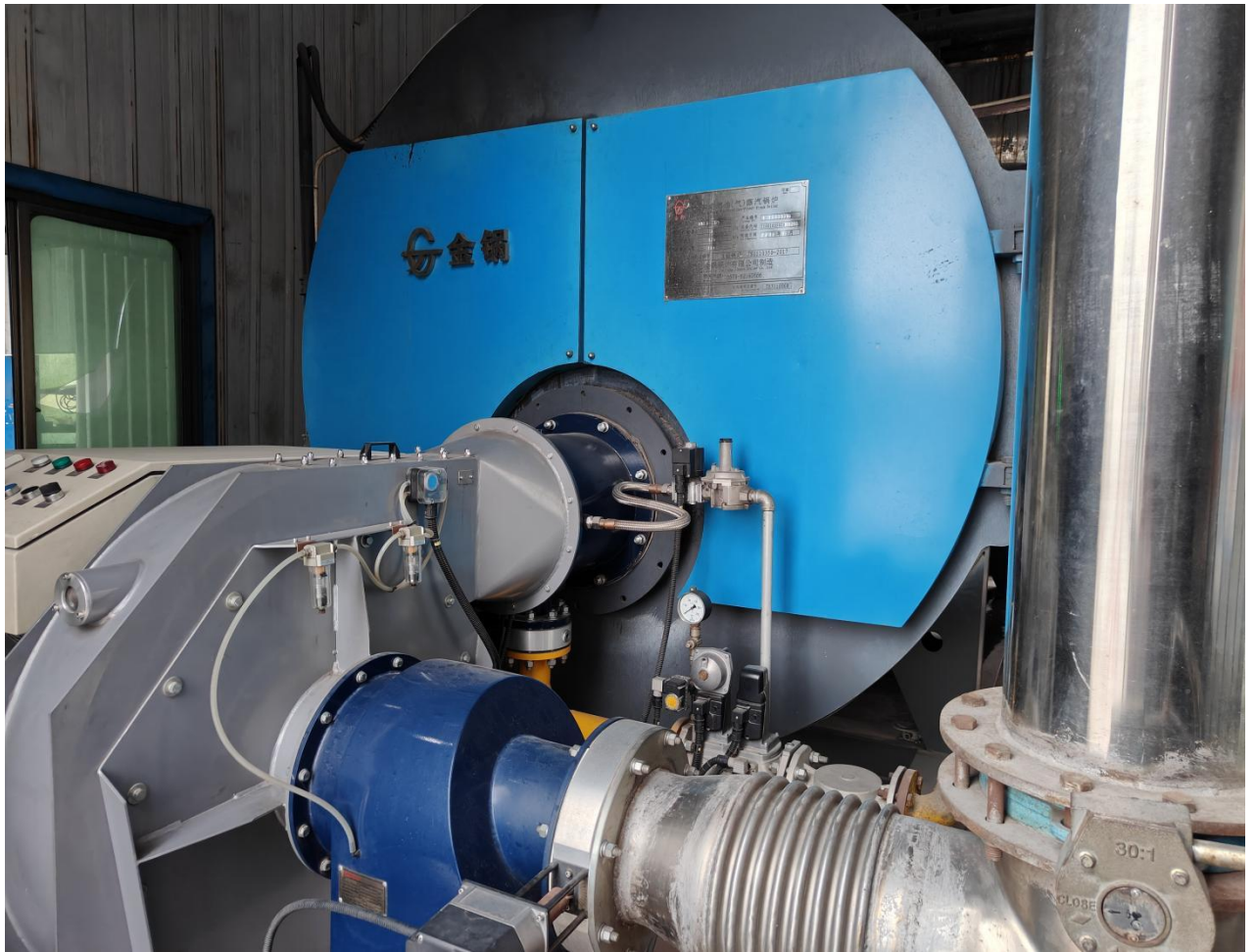
附件 7 低氮燃烧器照片
