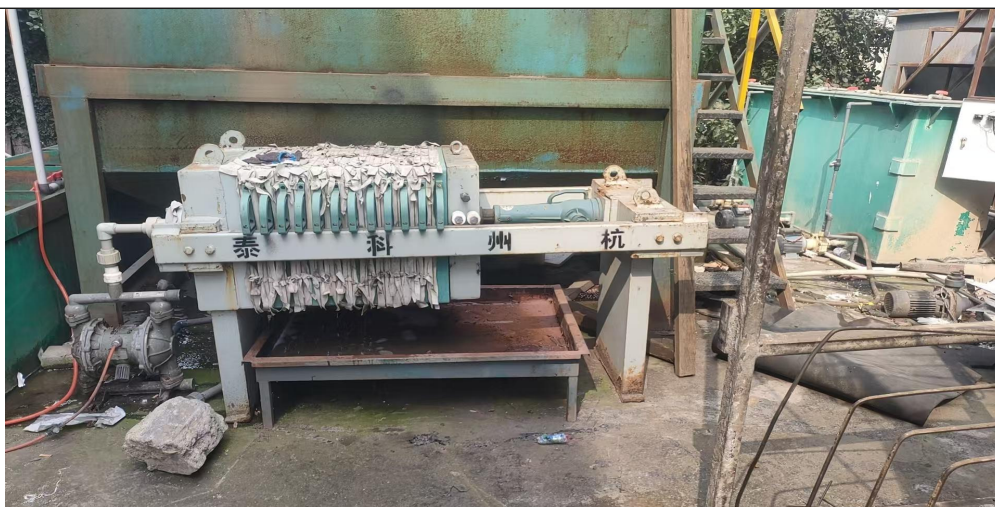
废水处理设施
